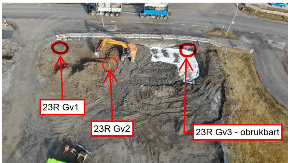
Figur 7. Grundvattenrör vid före detta drivmedelsstation. Grundvattenrör 23R Gv3 förstört vid återställande av mark efter rivning av stationen. Källa karta: (Ramboll Sweden AB, 2023a).
